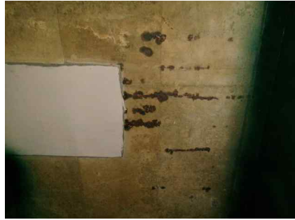
<배수지 1지 상부슬래브 철근노출>
