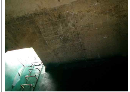
<배수지 2지 상부슬래브 백태>
