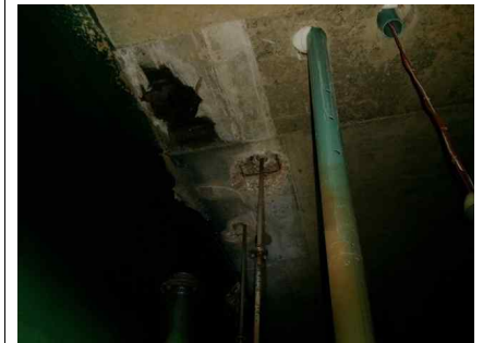
<배수지 2지 상부슬래브 파손 및 철근노출>
