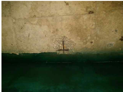
<배수지 1지 상부슬래브 파손 및 철근노출>
