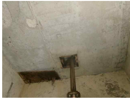
<유출밸브실 상부슬래브 거푸집미제거>
