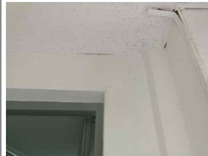
<관리실 내부 벽체 균열>
