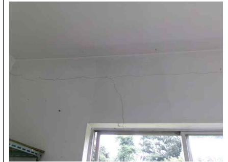
<수위계실 내부 벽체 균열>
