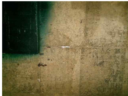
<배수지 1지 상부슬래브 백태>
