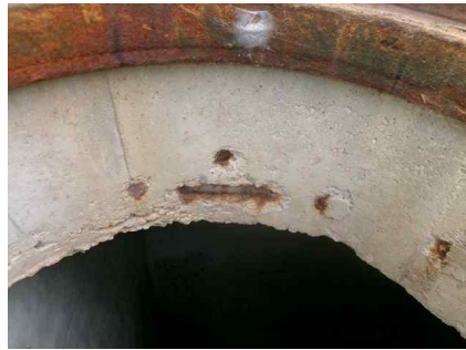
<유출밸브실 상부슬래브 철근노출>
