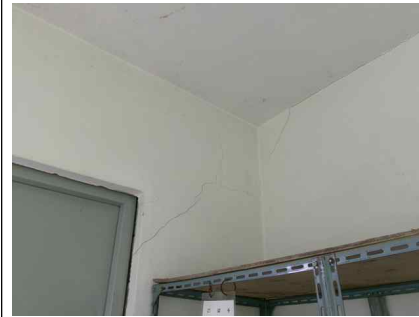
<수위계실 내부 벽체 균열>
