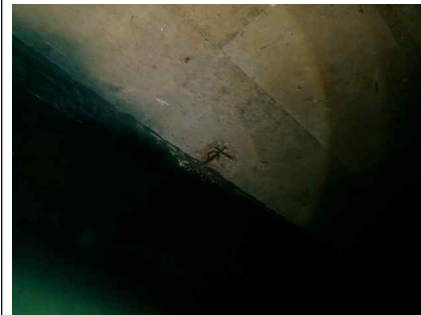
<배수지 2지 상부슬래브 파손 및 철근노출>
