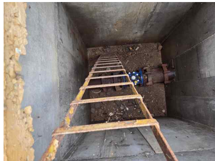
<유량계실 내부 사다리 부식>
