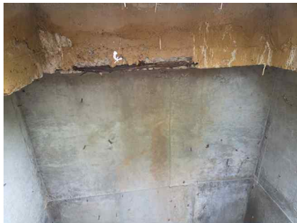
<유량계실 상부슬래브 철근노출>
