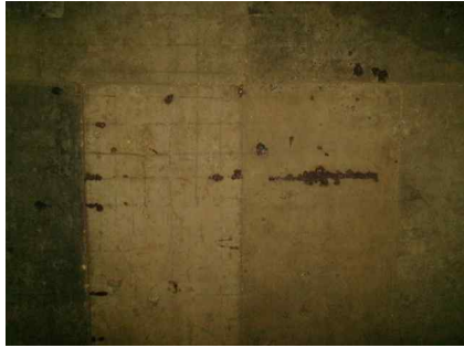
<배수지 1지 상부슬래브 철근노출>
