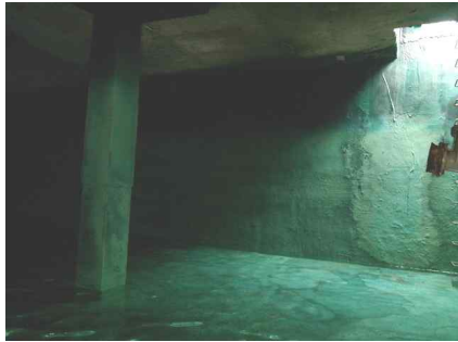
<배수지 1지 전경>
